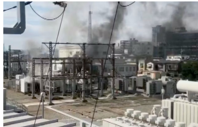
火災で煙を上げる埼玉県蕨市のJR東日本の変電所（2021年10月10日、近隣住民提供）=共同
