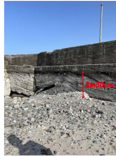
③黒島漁港の護岸 護岸の隆起が確認される。色が違う箇所を計測したところ2m50cmだった。
