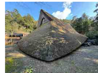
輪島市町野町の上時国家住宅(重要文化財)は一階が潰れる被害を受けた。
