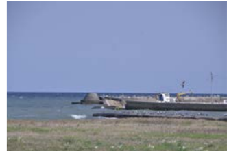
⑥破壊された護岸 護岸が崩壊。ここで津波が減衰され後背部の家屋流出を防いだ可能性
