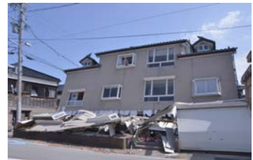
⑦建築物の被害
